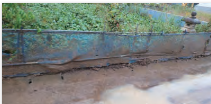
ネットに残る泥の跡から水の高さがわかる
